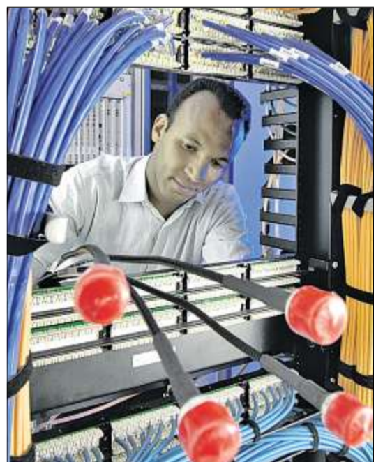
EIN INGENIEUR von Spie überprüft ein komplexes Datennetzwerk. Foto: pr
